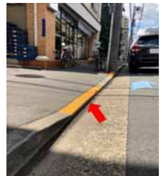
車道と歩道の段差5 cmの例（矢印） 前方に停車中の自動車を避けるために、歩道との段差5 cmを乗り越えて走行する場合がある。
